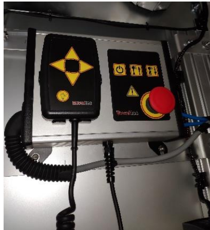
Ilustracija 25 Upravljački panel rasvjetnog stupa
